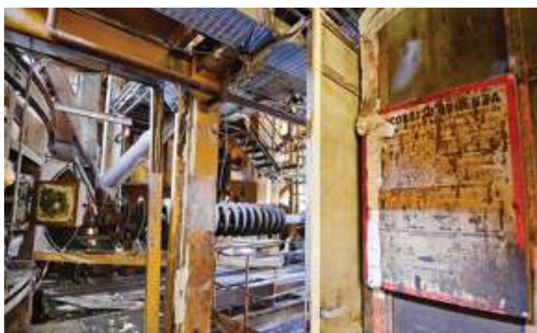
Il forno 70, uno degli impianti ancora da smantellare
